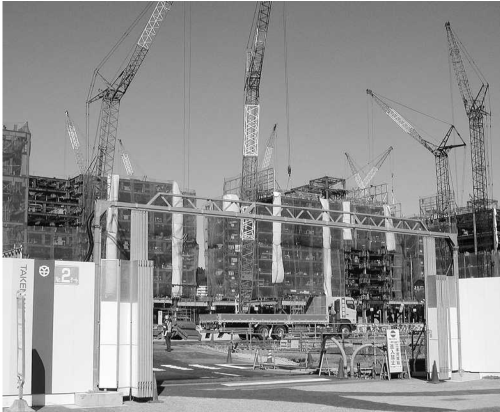
工事が強行される武田薬品研究所(東海道線側から11/3撮影)
